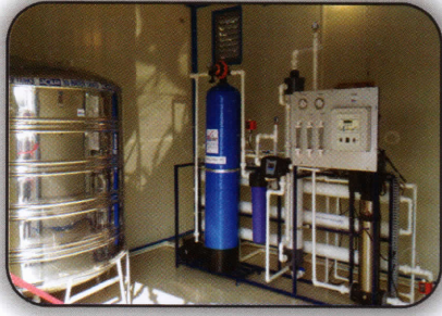
RO + UF system
